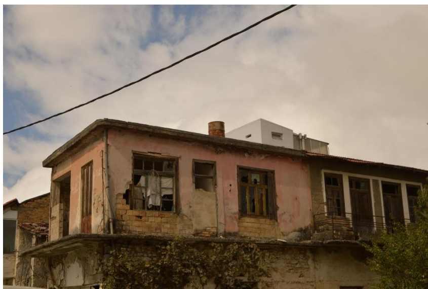
Εικόνα 19. Παλιό εγκαταλελειμμένο, ετοιμόρροπο κτίσμα που βρίσκεται ψηλά στο Τζερμιάδο.
